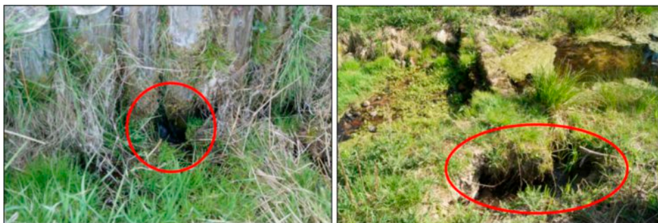
Ryc. 11. Zbiornik wodny nr 1 na cieku Krępa a) woda przepływająca przez nieszczelną ściankę b) erozja gruntu spowodowana omijaniem przez wodę zbyt krótkiej ścianki (fot. T. Dobek)
